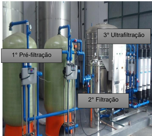
Figura 4: Sistema de ultrafiltração da água. Fonte: A autora (2017).
