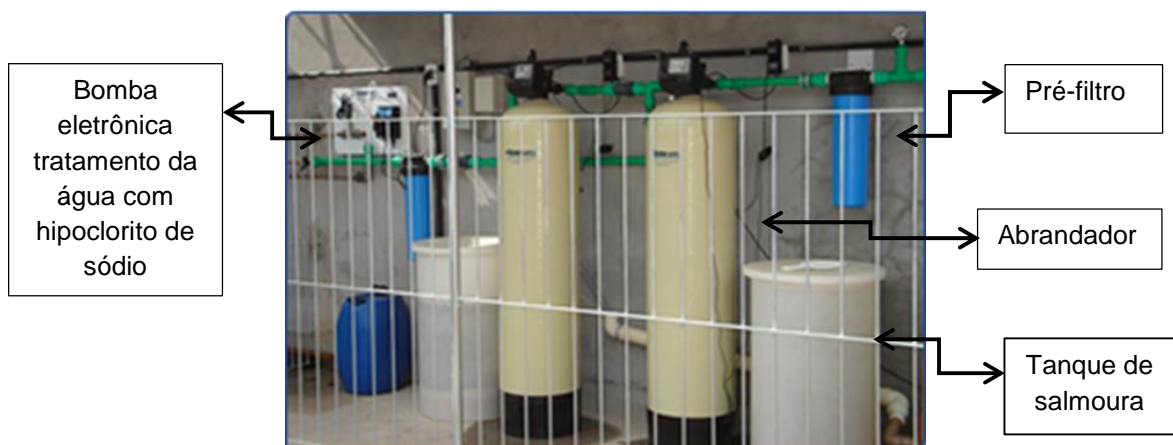
Figura 3: Sistemas de abrandadores de água na indústria de refrigerantes. Fonte: A autora (2017).
